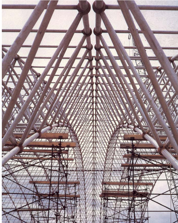
Fig. 2.10: Fotografía captada durante el montaje de la estructura de cubierta, ilustrativa de la ejecución de una de las juntas de dilatación.
